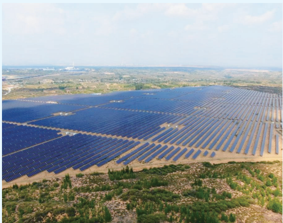
榆能新能源公司光伏项目
