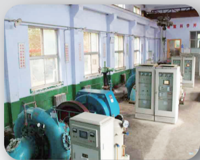
仁创新能源公司安徽大别山水电站控制室
