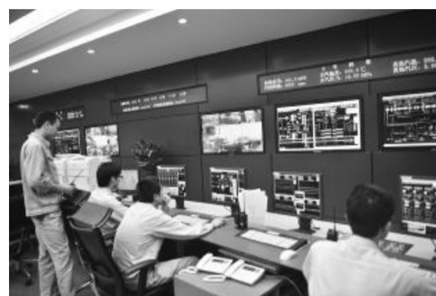
红海湾现代化电子操控室,锅炉等核心设备全部采用高科技手段来调控 董菁/摄
