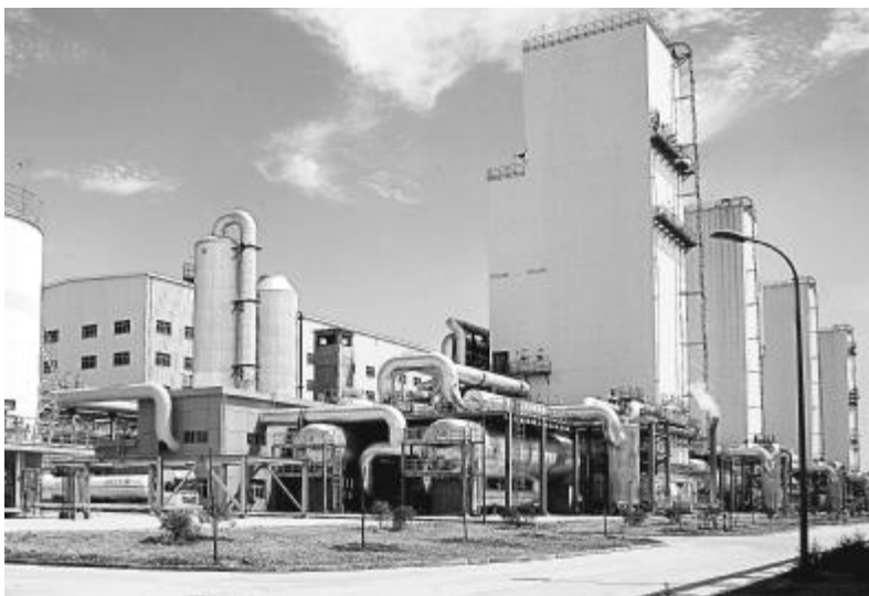
2010年5-8月,杭氧自行研发、自主设计制造的继大唐国际五万八后国内单套规模最大的化工型内压缩空分设备——神华六万空分设备开车成功
