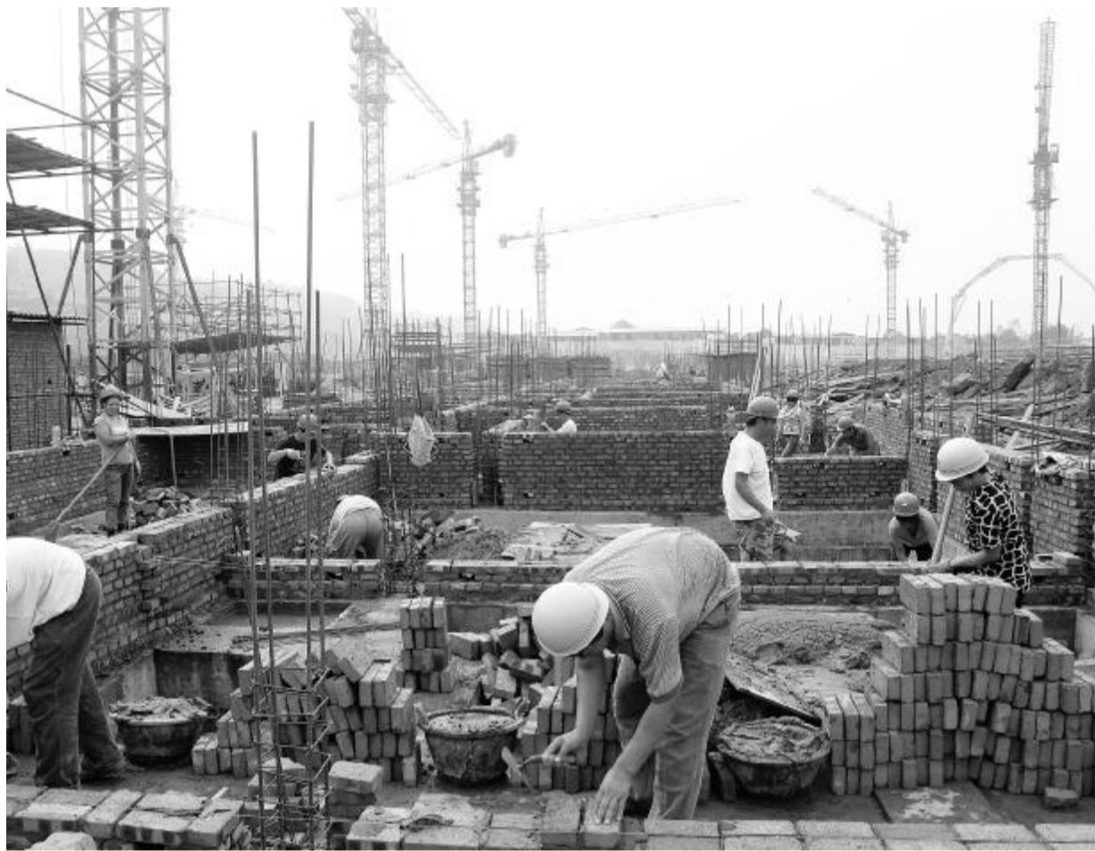
中铁八局建筑公司承建四川屏山县移民迁建工程施工现场
