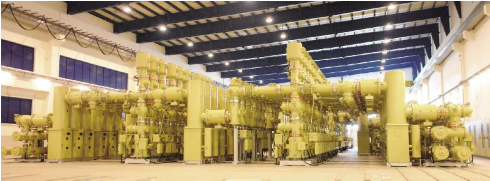
西电集团产品在新加坡乌兰230kV变电站运行良好
