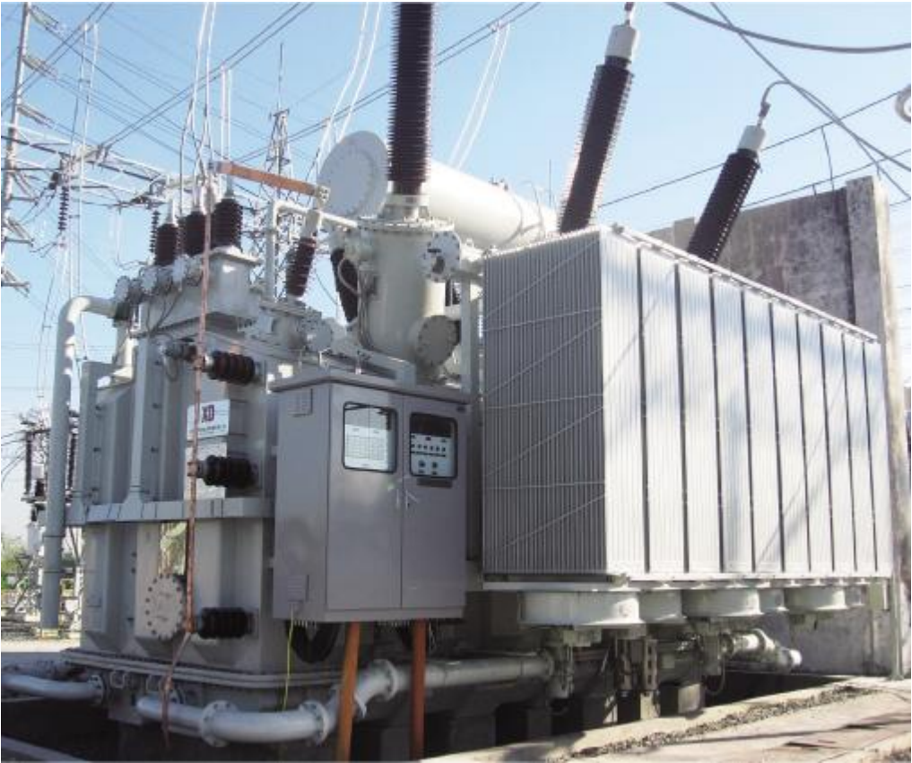
出口到菲律宾的500kV变压器
