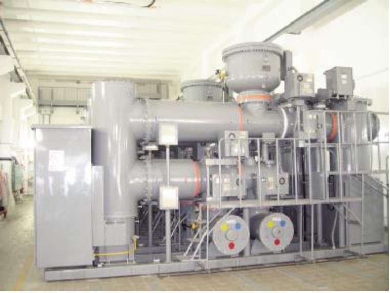
西电集团132kV GIS产品在香港中华电力米埔变电站运行
