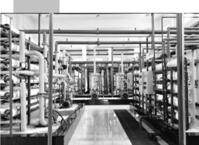
国内首创的煤化工污水深度处理工艺
