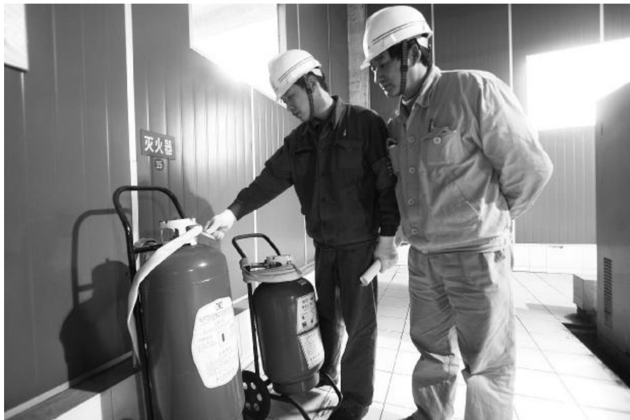
消防设备检查
