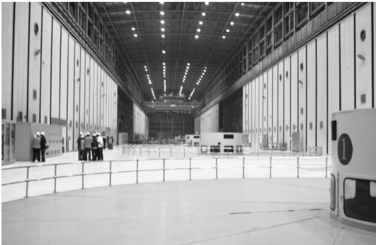
中国电力投资集团公司下属黄河水电公司的拉西瓦水电站,自主创新体现在山洞支护、山体加固、75万伏电压、导流洞的开挖等各个方面。据不完全统计,该水电站在筹建的4年中,仅设计优化和工程优化,就节约资金2.8亿元,现为黄河流域大坝最高、单机容量最大的水电站,主要以发电为主,是“西电东送”北通道的骨干电源点。 本报记者 万斯琴摄
