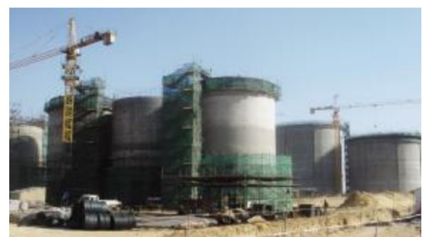
集团总承包施工的内蒙古不连沟选煤厂是目前国内年入选量最大的选煤厂
